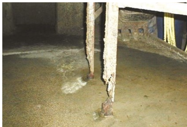
L'effet de pile produit une dégradation accélérée des métaux.
